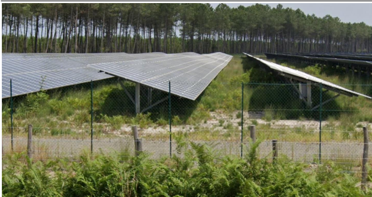
Centrale photovoltaïque de VALECO © Google
